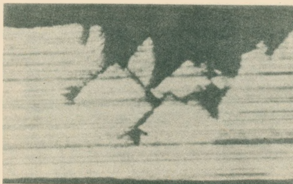
Rys. 7. Typowe dla korozji międzykrystalicznej wżery uzyskane sztucznie w warunkach laboratoryjnych w przypadku połączenia ołowianej powłoki kabla z dodatnim biegunem źródła prądu. Gęstość prądu 3 \cdot 10^{-6} A/cm 2 . Czas trwania badań 6 miesięcy. /Przekrój mikrotomowy przez miejsce wżeru na powłoce kabla. Powiększenie 40-krotne/
