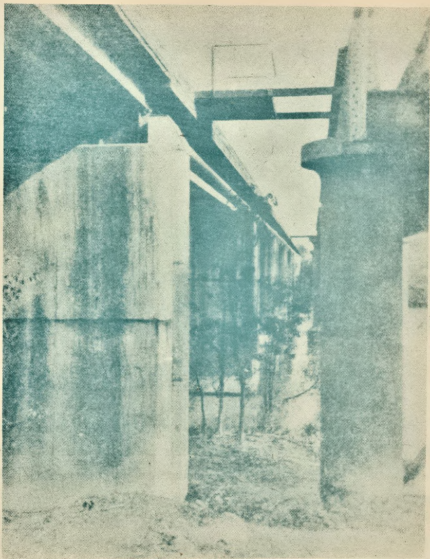
Rys. 20. Częściowy widok przejścia kabla rurą przez most kolejowy nad rzeką Goulburn w pobliżu Seymour
