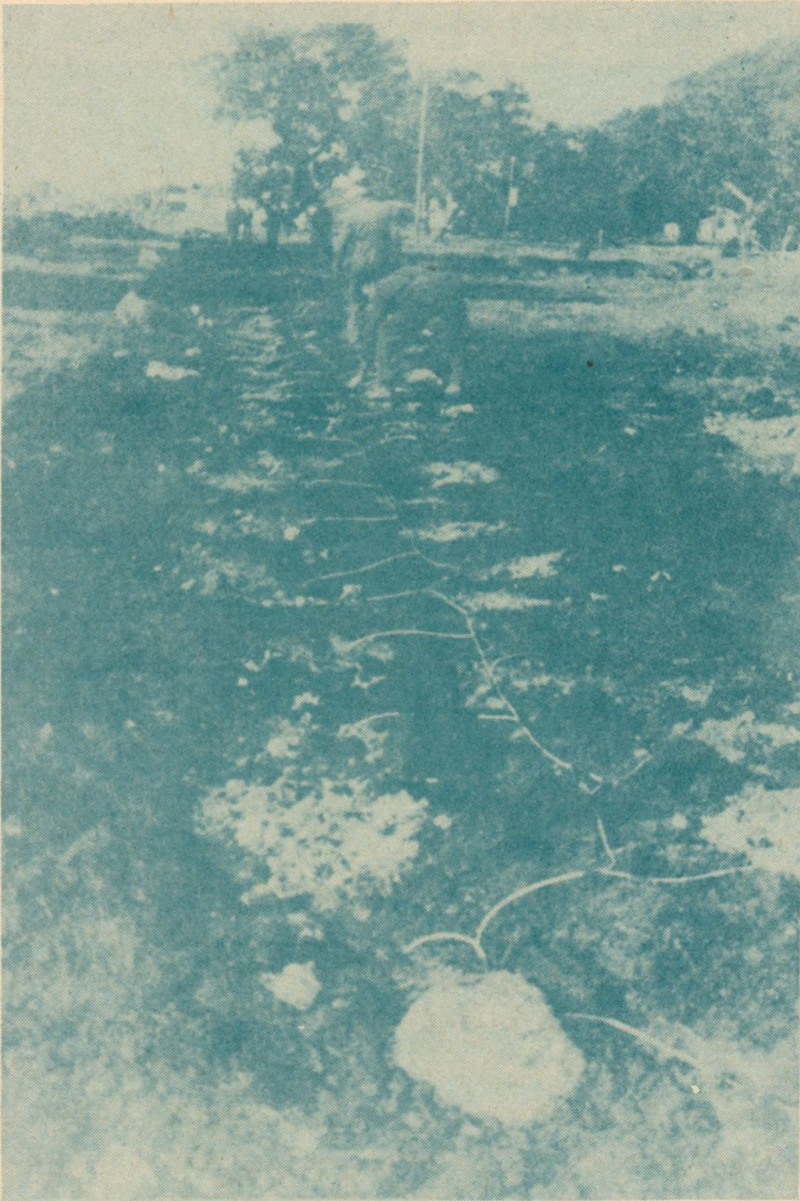
Rys. 13. Wsadzenie skał dla utworzenia rowu kablowego w pobliżu miejscowości Wollert w stanie Wiktorja
