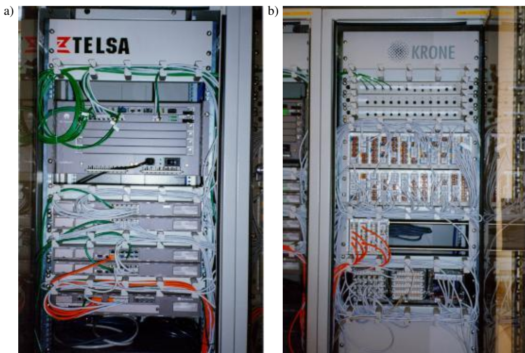
Rys. 2. Szafy dystrybucyjne jednego z węzłów sieci komputerowej Instytutu Łączności: a) urządzenia sieciowe; b) panele krosujące
