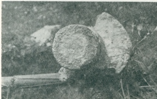
Rys. 11. Skorodowane dno anody aluminiowej pokryte galaretowatą masą produktów korozji
